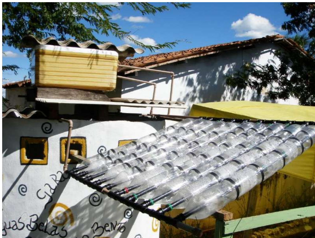
Figura 4– Sistema de aquecimento de água para banho.
