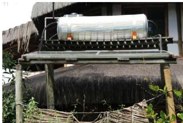
Figura 23 – Placa solar com boiler
