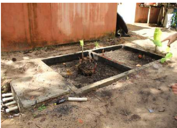
Figura 14 – Filtro para águas negras em construção
