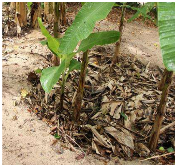
Figura 13 – Filtro para águas cinzas em funcionamento
